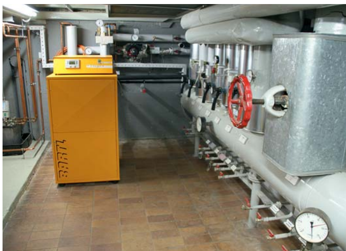
Innenteil der Split-Wärmepumpe im Technikraum
