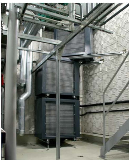
Aufstellung der Verdampfer im Maschinenhaus des BHKW
