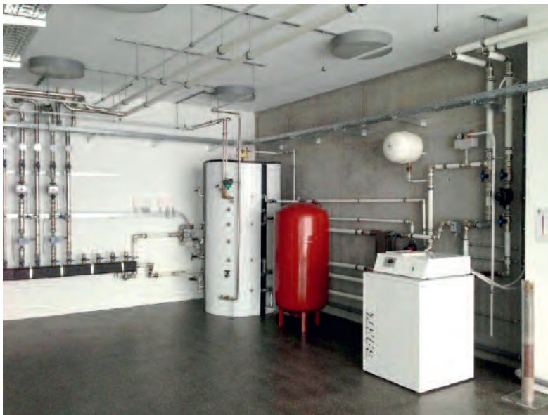
▲ Ebenso durchdacht wie das Gebäude mutet der Heizungsraum an. Rechts im Vordergrund ist eine Gesteinsprobe der Bohrungen für die Erdsonden zu sehen.
