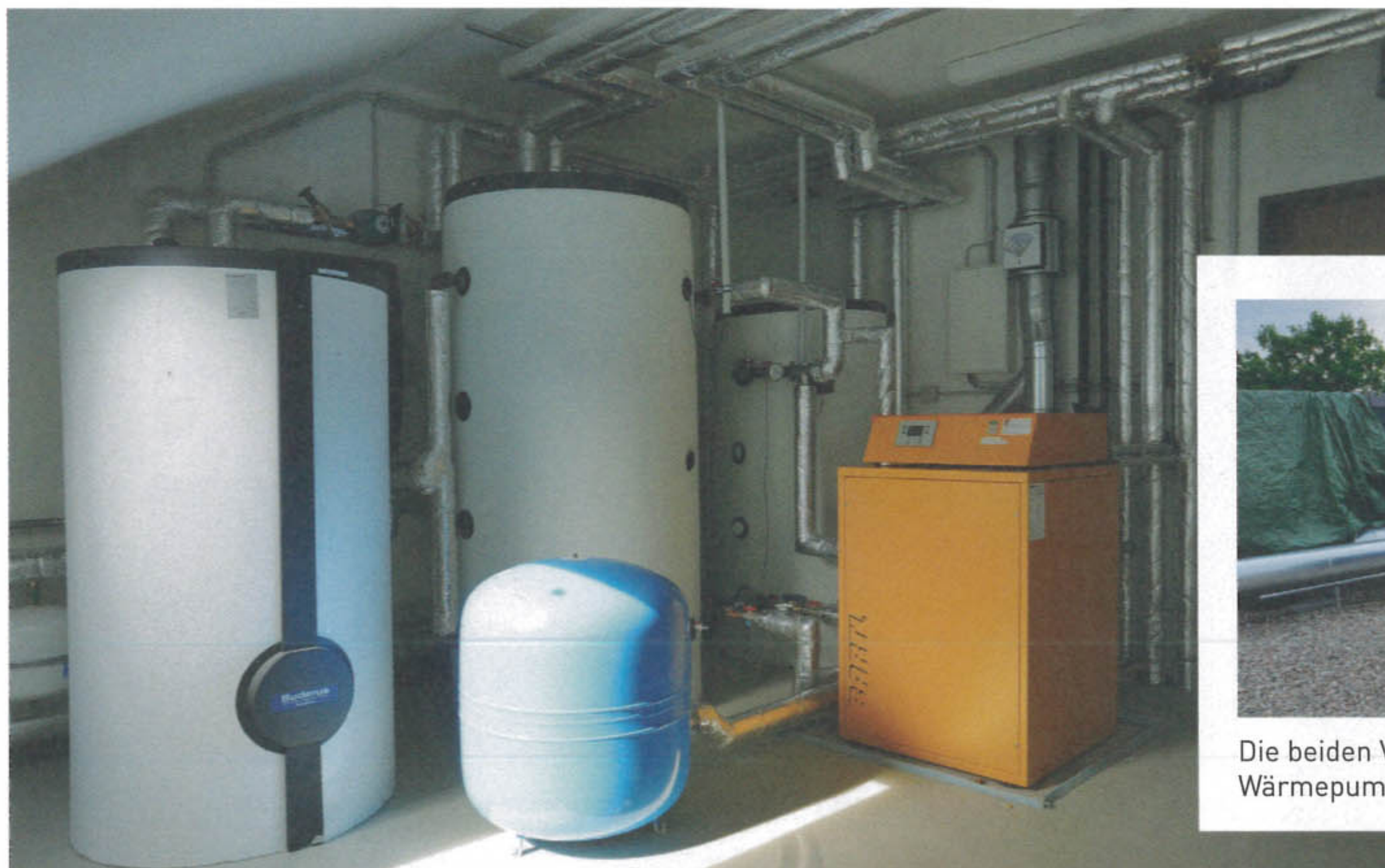
Der Technikraum im Dachgeschoss mit der Inneneinheit der Wärmepumpe, dem Gasbrennwertgerät und dem Warmwasserspeicher.
